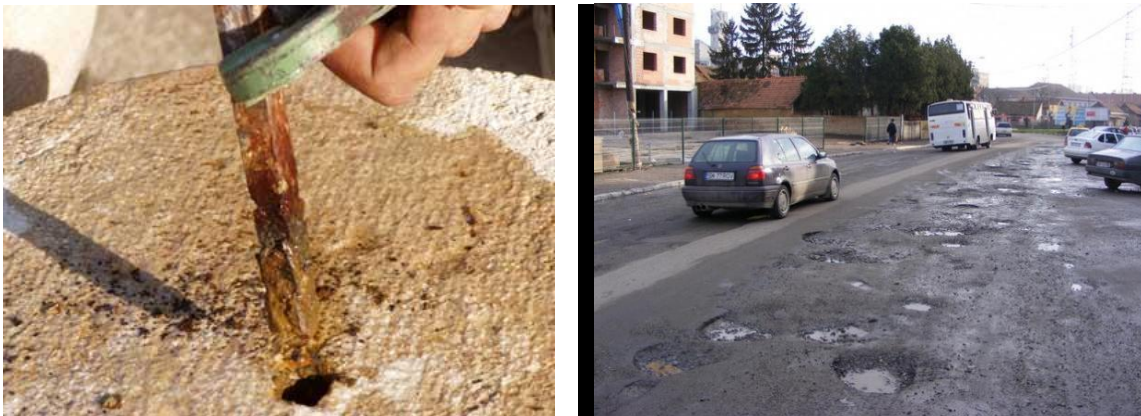
Fig. 7. Efectul coroziv a sării NaCl asupra metalului și asfaltului
