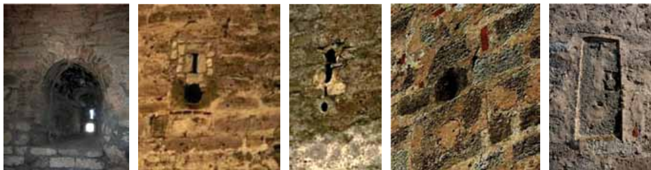
Fig. 16. Tighina, cetatea, nișă în arc, vedere din interior, astupată cu ambrazuri de artilerie (Foto: Nesterov, 2020) (a); cetatea, ambrazuri de artilerie, înlocuind ambrazurile verticale, vedere din exterior (Foto: Nesterov, 2020) (b–d); turnul nord-vest, murtieră de artilerie astupată cu silueta unui vas orientat (Foto: Krasnojon) (e)
